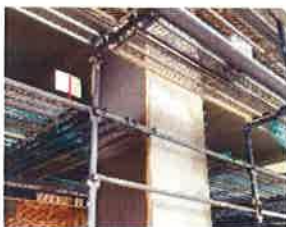
既存の昭和50年代のタイルが劣化し剥離していた部分を、除去しました。タイルの除去後、モルタルで表面を整えて乾燥を待ちます。
